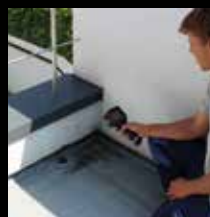
Scoprire infiltrazioni nei tetti
